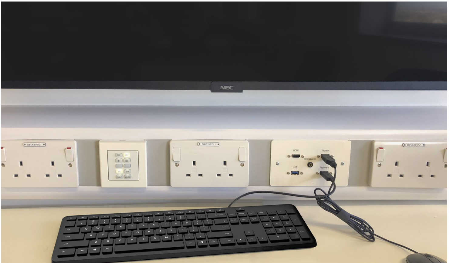
Jeder der 18 Studenten-Arbeitsplätze verfügt über AV-Anschlüsse für eine Tastatur, Maus und Mobilgeräte sowie die Möglichkeit zur Quellenumschaltung und lokalen Displaysteuerung mit einem Extron EBP 110 MK eBUS®-Tastenfeld mit 10 Tasten.
