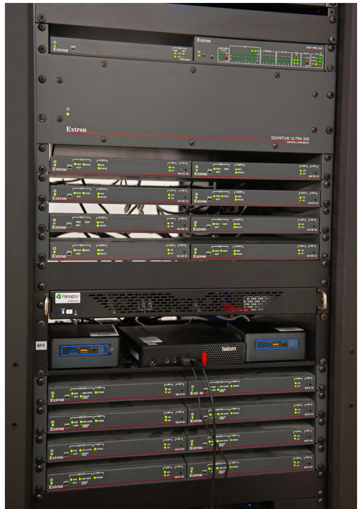
Il rack della sala di controllo contiene encoder e decoder professionali NAV e NAVigator, oltre al processore videowall Quantum Ultra, al processore di controllo IPCP Pro e varie sorgenti di contenuto AV.
