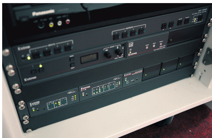
El equipamiento de Extron alojado en el atril facilita una instalación más limpia y proporciona espacio adicional para enseñar.
