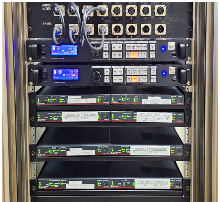
Die drei Konferenzräume sind jeweils mit einem AV-Rack mit vier NAV Pro-Kodierern und vier -Decodern ausgestattet, die das AV über IP-Netzwerk zusammen mit dem oben im Rack stehenden Ethernet-Switch, der das Unternehmens-Datennetzwerk des Instituts nutzt, implementieren. Foto mit freundlicher Genehmigung von Neuroo Digitech.
