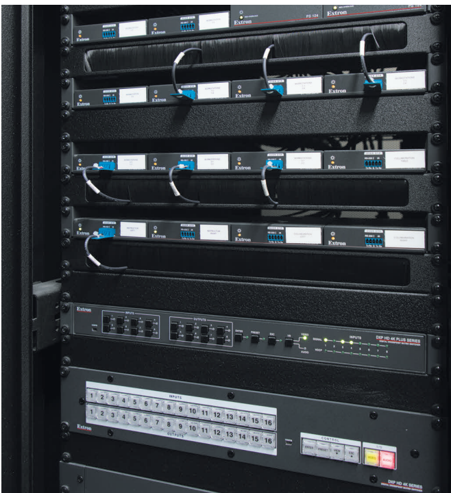
Die AV-Systemkomponenten sind im Rack des Technikraums hinter der 6x2 Videowand des Labors untergebracht.
